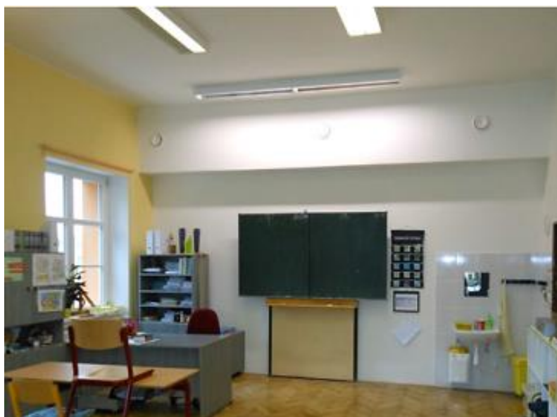
Foto: Dispozice škol často umožní skloubit technické řešení a estetické provedení VZT (zdroj: ATREA s.r.o.).
